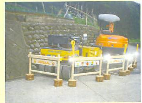
・反射板付…夜間・トンネル内で光ります
